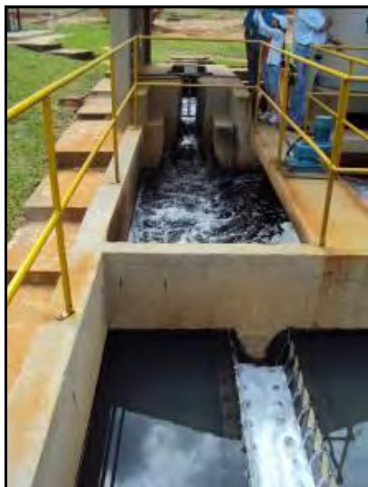
Figura 5.29.: Floculador da ETE.
