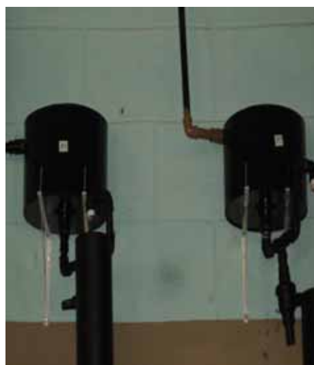
Figura 15: Detalhe da entrada dos filtros
