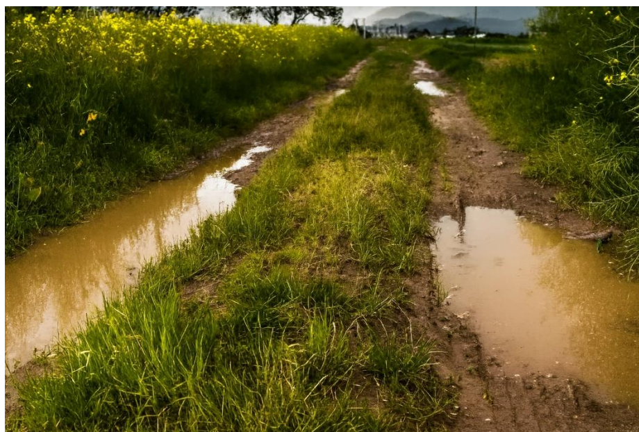
Figura 2 – Problemas relacionados ao grande volume de chuvas vistos em estrada rural do município de Guaratinguetá (SP).
