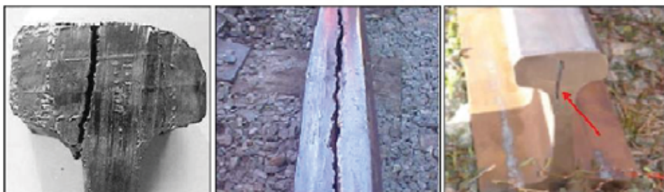
Figura 16 - Exemplos de trincas verticais no boleto. [18]
