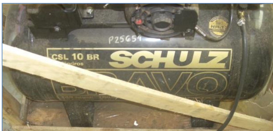
Figura 10. Compressor de ar
