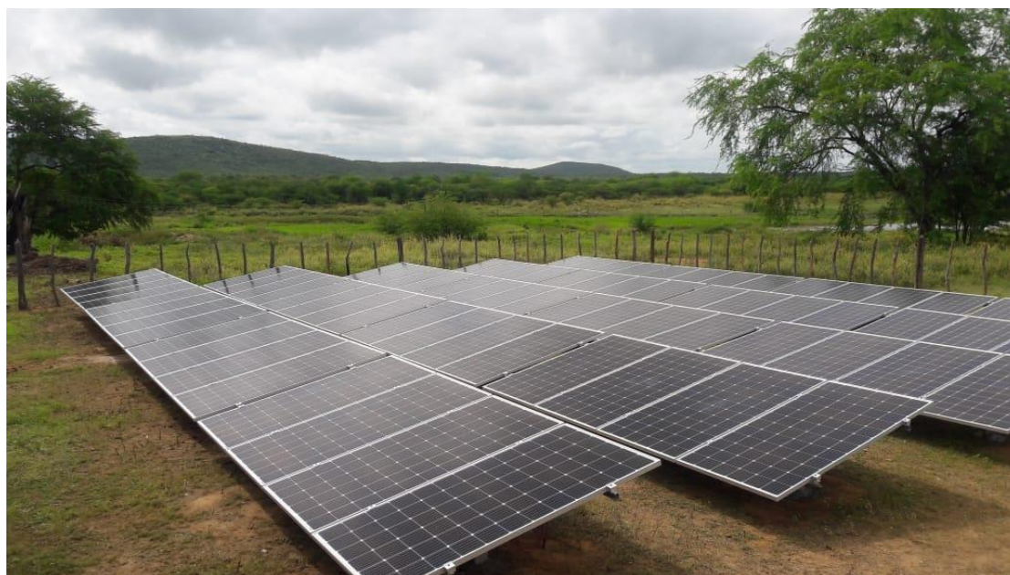
Figura 43: Usina solar do Frigorífico Terra Conquistada no Assentamento Palestina, Independência, Sertão dos Inhamuns-Crateús - CE
