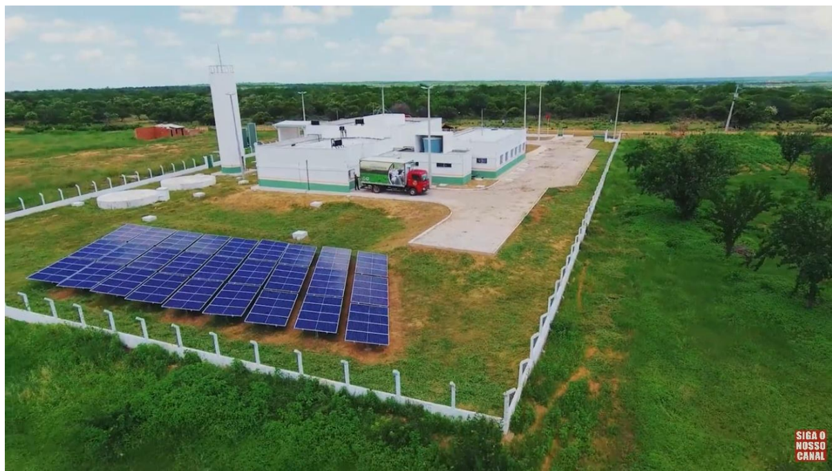
Figura 44: Usina solar do Frigorífico Terra Conquistada no Assentamento Palestina, Independência, Sertão dos Inhamuns-Crateús - CE
