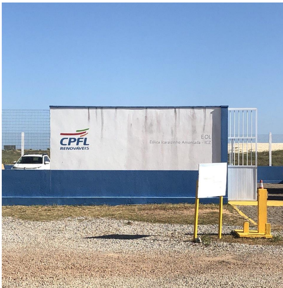
Figura 10: Escritório e subestação do Complexo Eólico Icaraizinho da CPFL Renováveis – State Grid.
