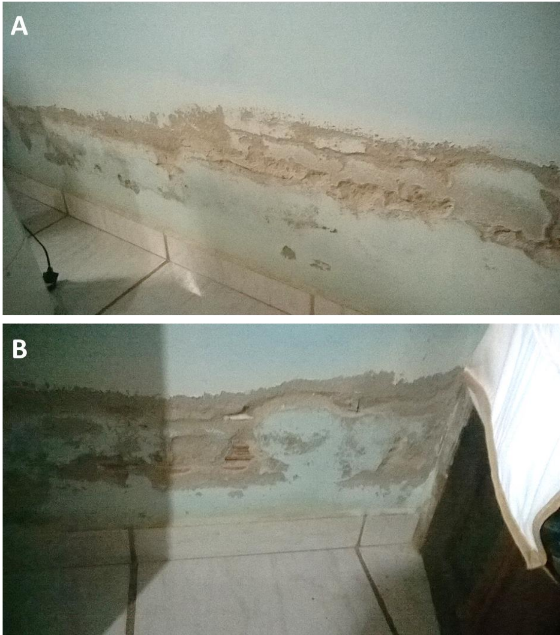
Figura 28. Biodeteriorações em residência - área interna (Município de Ribeirão Claro/PR).
