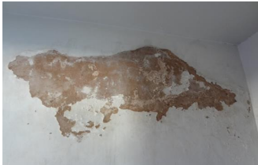
Figura 3. Terceira fase das biodeteriorações: deslocamento do reboco.
