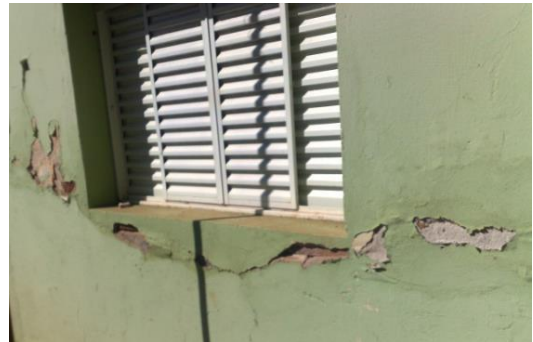
Figura 4. Quarta fase das biodeteriorações: rachaduras.
