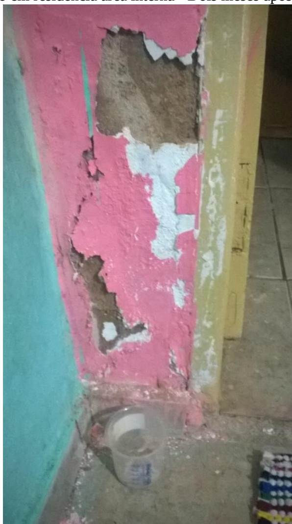
Figura 26. Deformação em residência área interna - Dois meses após reforma (Ourinhos/SP).
