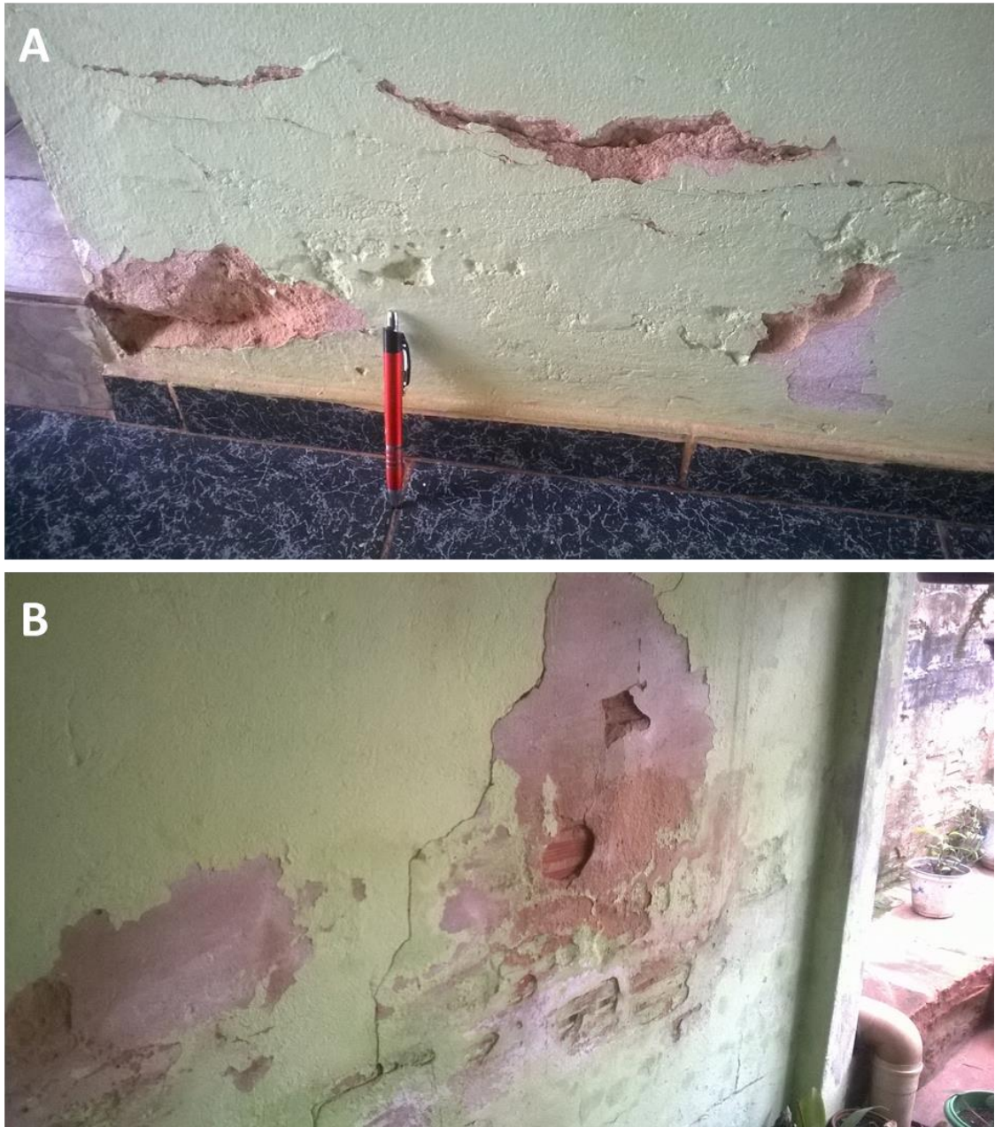
Figura 27. Biodeteriorações na área externa de residência (Município de Ribeirão Claro/PR).
