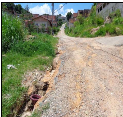
FOTO 1. Vista geral de processo erosivo avançado ocasionado pela ausência de estrutura de contenção.
