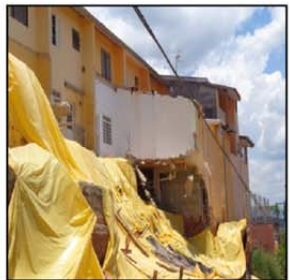
Vista de casas que não resistiram ao rompimento dos muros de contenção após deslizamento
