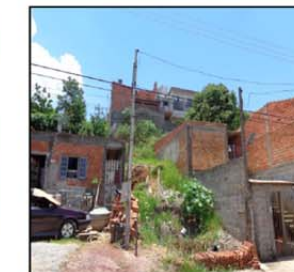
Vista geral de cicatriz de escorregamento em talude de corte próximo a moradia
