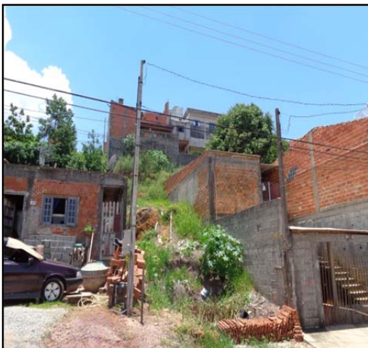
FOTO 11. Vista geral de cicatriz de escorregamento em talude de corte próximo a moradia.
