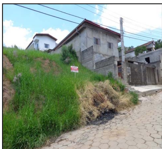
FOTO 5. Vista geral de corte em talude onde há, terreno sendo comercializado em área de risco
