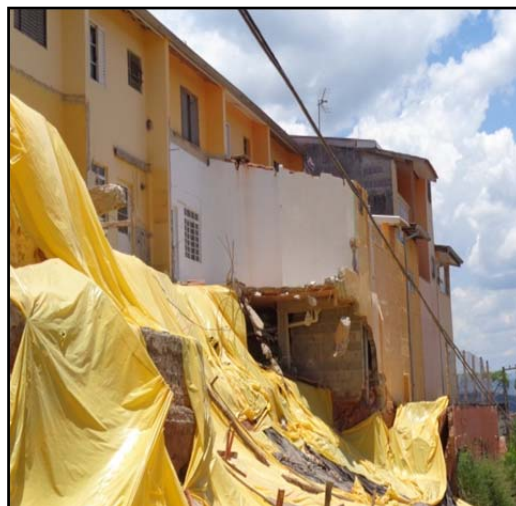
FOTO 6. Vista de casas que não resistiram ao rompimento dos muros de contenção após deslizamento
