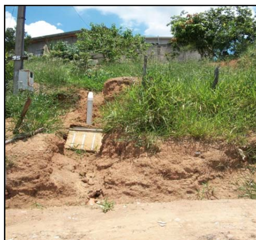
FOTO 6. Vista de casa com ausência de serviço de saneamento despejando seu efluente no solo.
