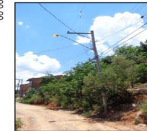
Vista de corte em talude e tombamento de poste devido a processo de arrastamento
