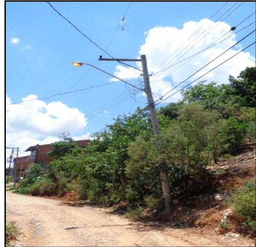
FOTO 10 Vista de corte em talude e tombamento de poste devido a porcesso de arrastamento
