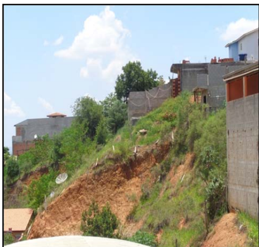
FOTO 5. Vista geral de cicatriz de escorregamento em talude de corte próximo a moradia.
