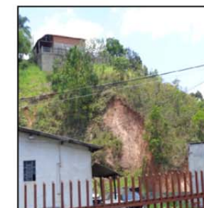
Vista geral de cicatriz de escorregamento em talude de corte próximo a moradia
