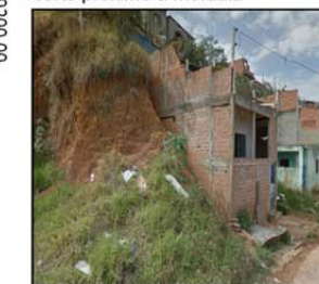
Vista de casa com construída rente ao corte do talude já apresentando sinais de movimentação
