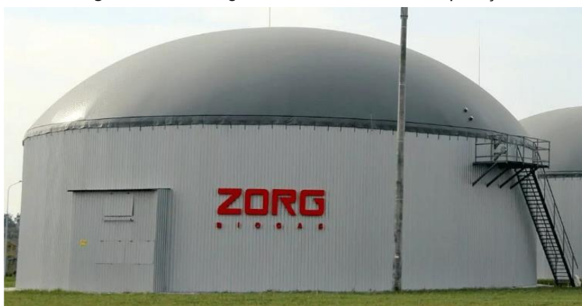
Figura 2.5 – Biodigestor modelo CSTR em operação
