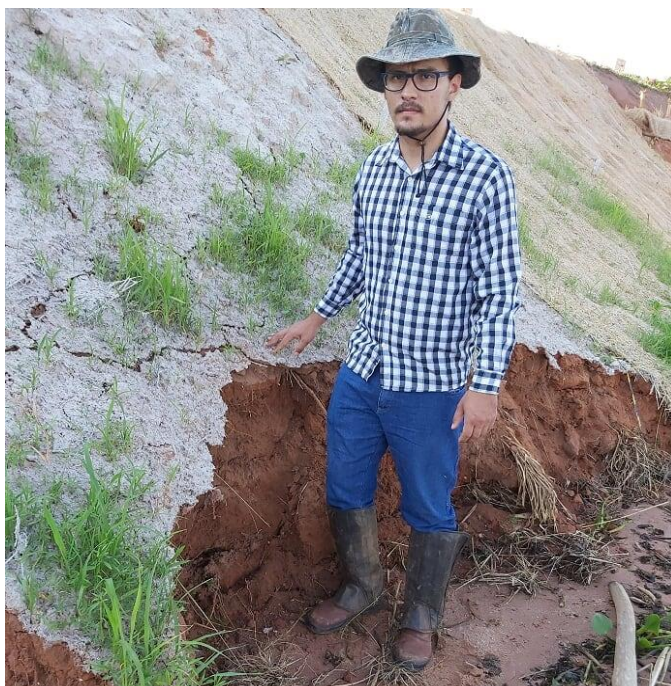
Figura 113 - Solapamento no Talude 227 (foto de 16/10/2019).
