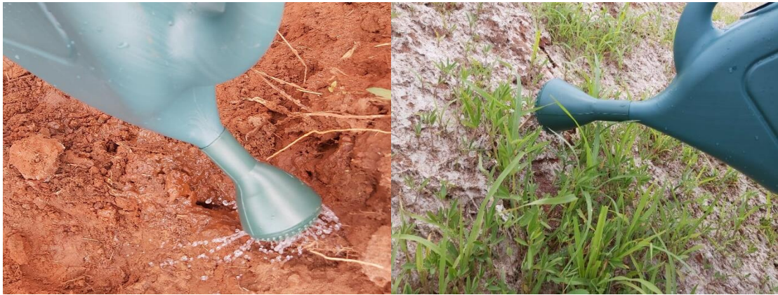
Figura 115 - Dispersão do inseticida Fipronil no Talude 227.
