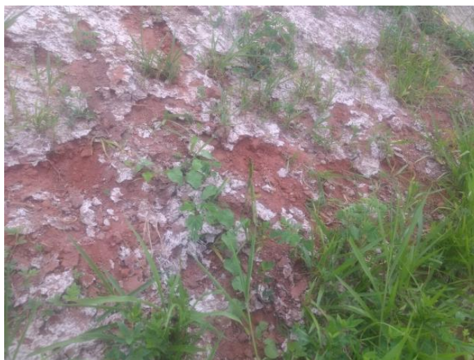
Figura 123 - Solo parcialmente exposto face ao desprendimento do Mix de Sementes na Parcela 1 no dia 27/11/2019.
