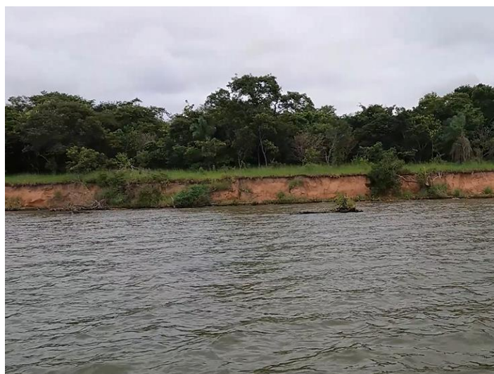
Figura 91 - Talude 228 - município de Três Lagoas (MS).
