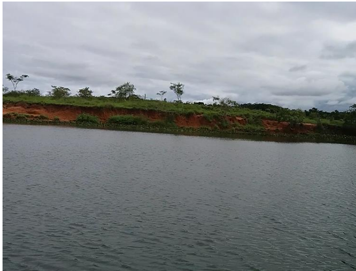
Figura 88 - Talude 225 – município de Selvíria (MS).
