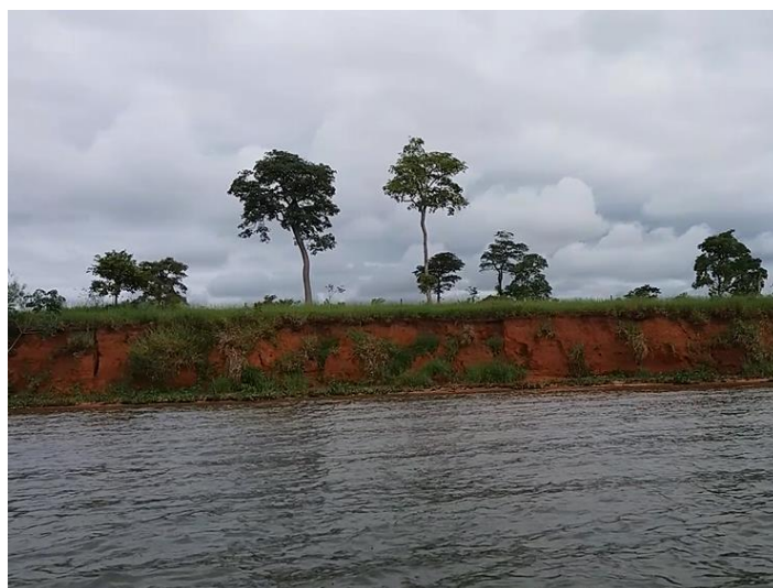
Figura 90 - Talude 227 - município de Três Lagoas (MS).
