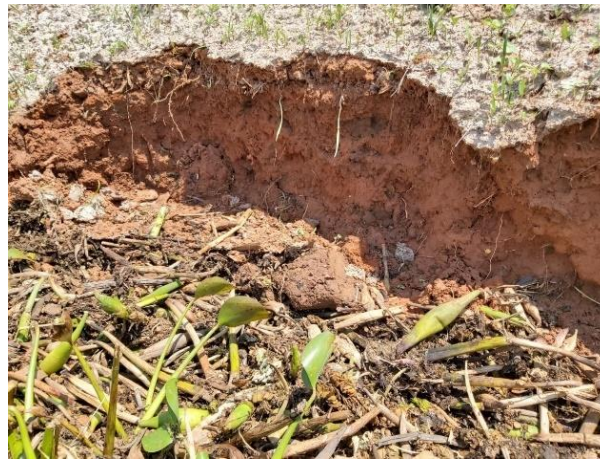
Figura 121 - Solapamento identificado na Parcela 1 no dia 29/09/2019.
