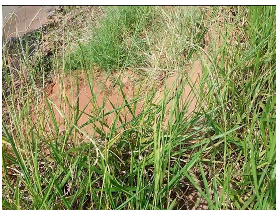
Figura 7. Sétimo ponto – visão do topo do Talude 227.
