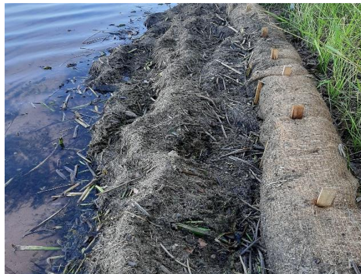
Figura 168 - Nível da água atingindo os biorretentores no dia 05/03/2020.
