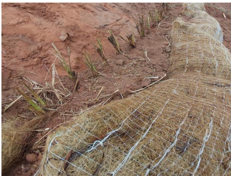
Figura 73 - Capim vetiver plantado acima do biorretentor.
