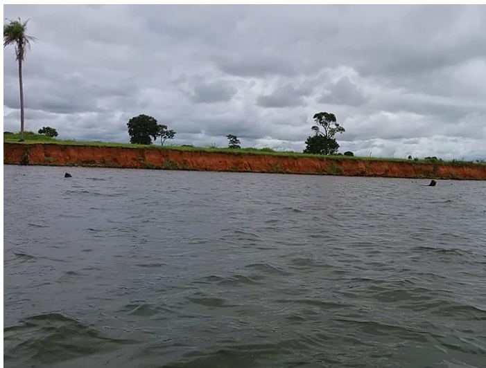
Figura 92 - Talude 229 - município de Três Lagoas (MS).
