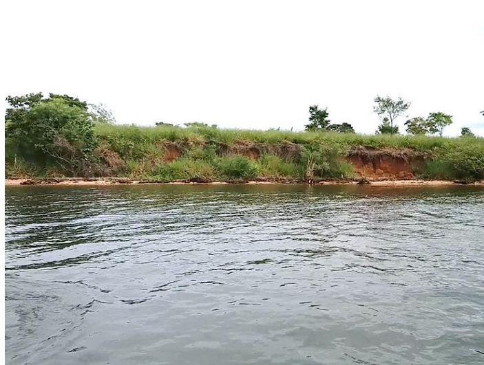
Figura 87 - Talude 224 – município de Três Lagoas (MS).
