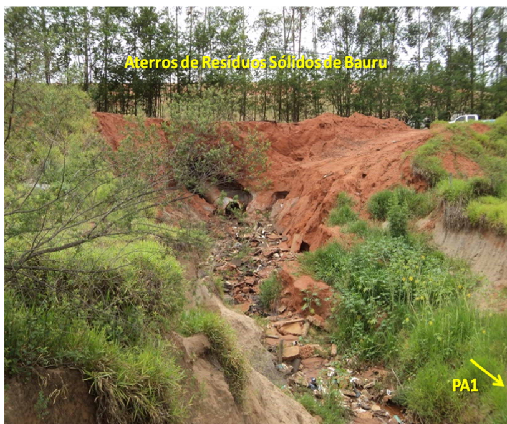
Figura 15 – Erosão à jusante do aterro de resíduos sólidos urbanos de Bauru, destaque para a localização do aterro e o ponto de coleta de águas superficiais PA1.
