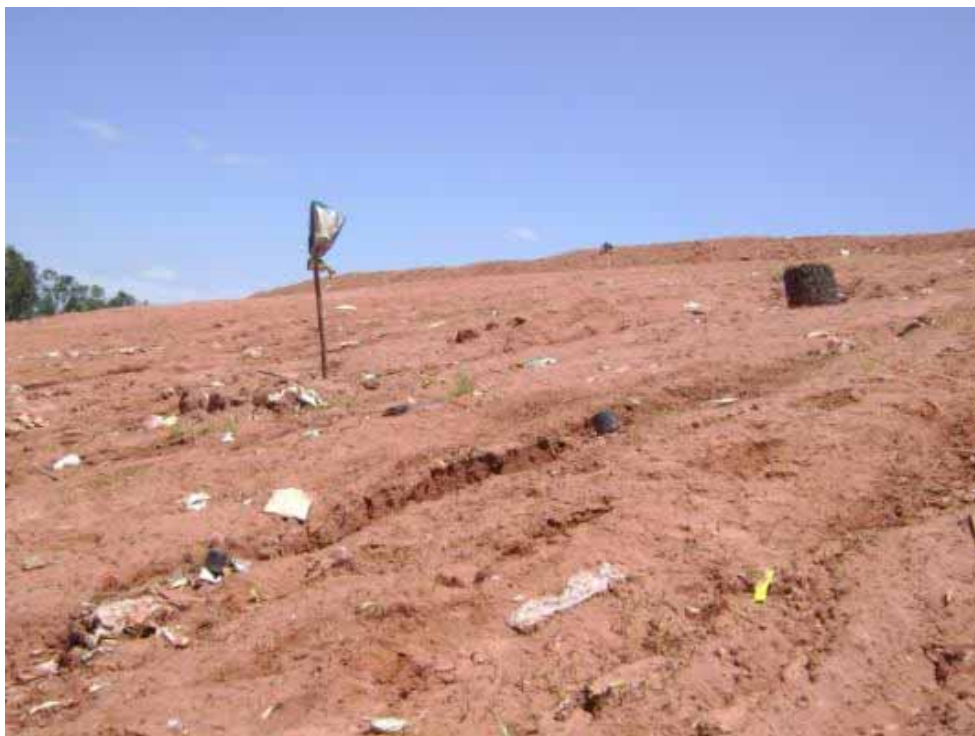
Figura 34 – Sulcos erosivos e resíduos sólidos expostos em camadas fechadas do aterro sanitário de Bauru.
