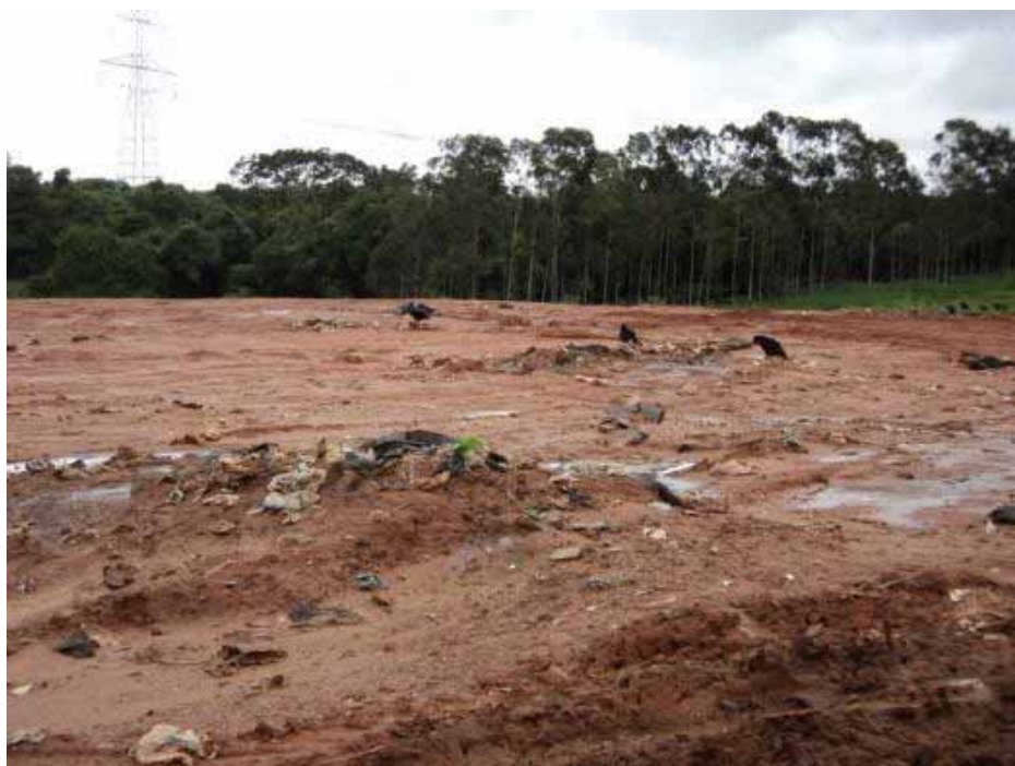
Figura 32 – Resíduos sólidos expostos em camadas fechadas do aterro sanitário de Bauru.
