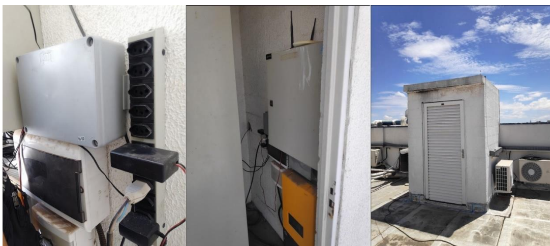
Figura 8 - Painel elétrico do Smart Campus com régua de alimentação fixada na parede.
