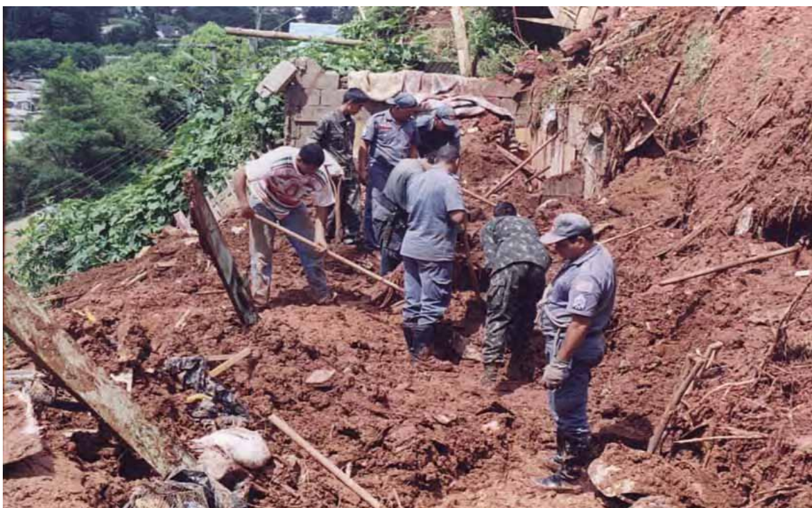
FIGURA 14: Bombeiros e defesa civil ajudam na retirada de vítimas Britador jan/2000
