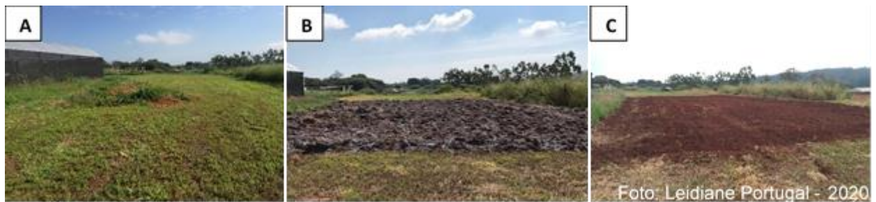
Figura 8- A) Área antes do início das operações de preparo do solo B) Solo arado e corrigido C) Incorporação do calcário e quebra de torrões
