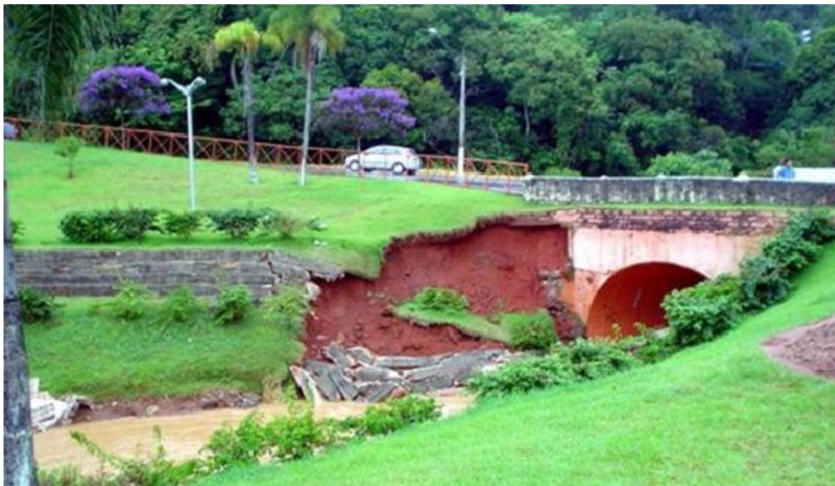
Figura 8- Erosão na margem direita do Ribeirão do Chá, em uma das principais vias de acesso ao centro da cidade de Itapetininga no ano de 2004. Fonte: BARROS, 2004.
