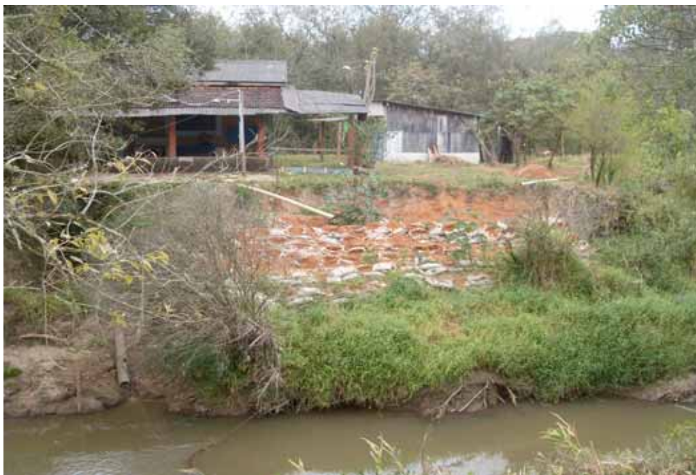
Figura 28 – Erosão causada por água residual (Rio Mandú).
