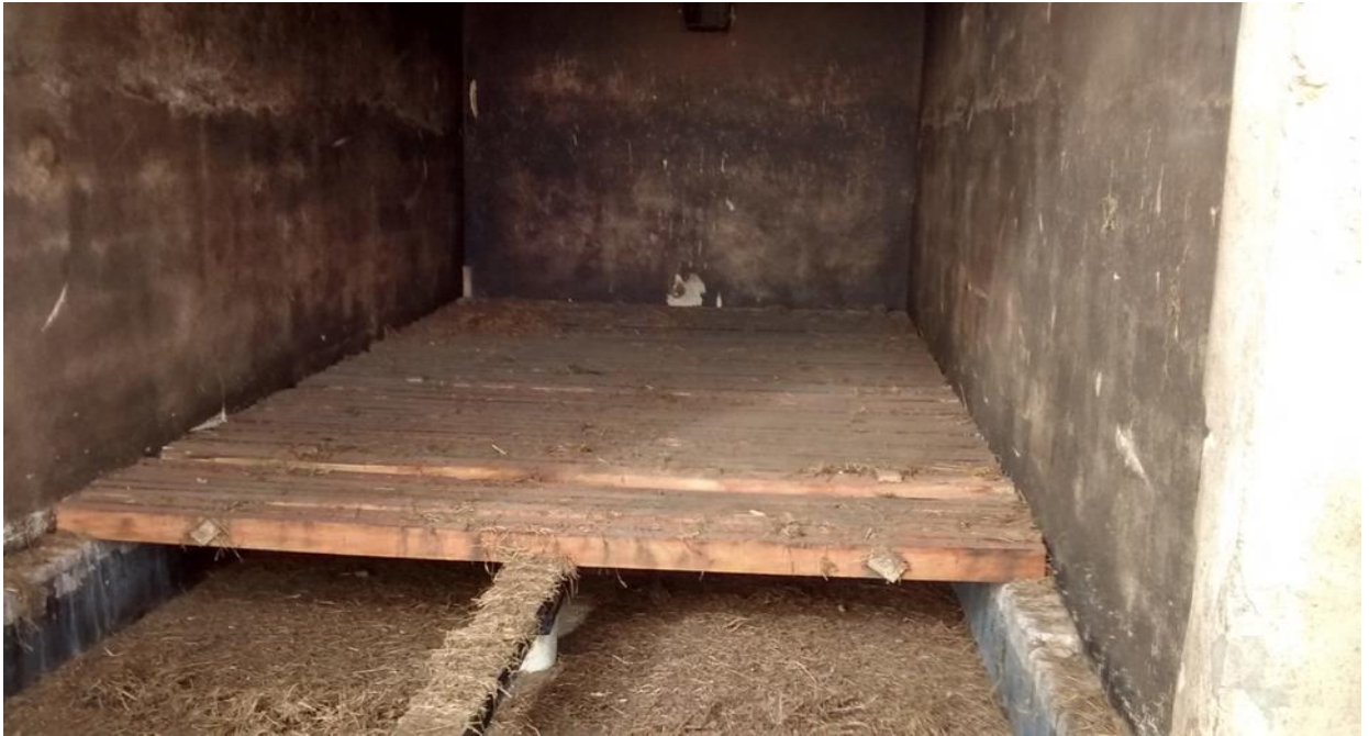
Figura 4. Câmara/ túnel de compostagem (plennum por onde o vapor é injetado). Fonte: Do autor.
