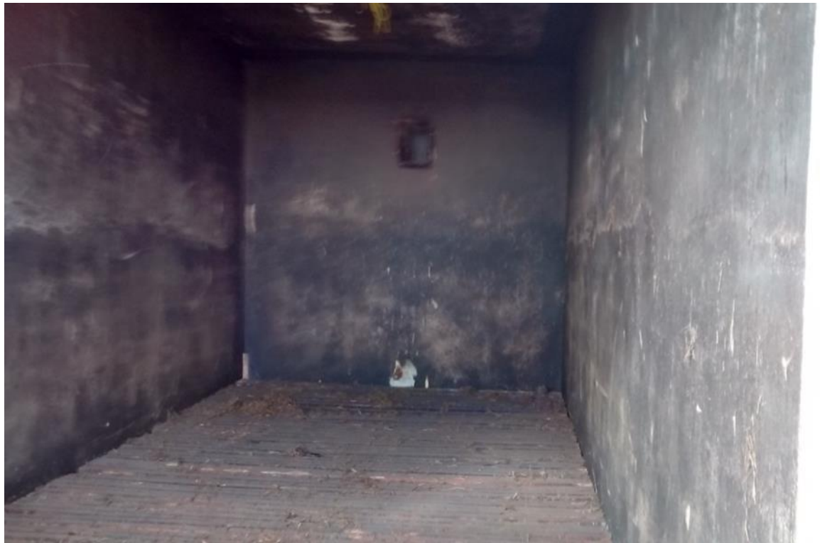
Figura 3. Câmara/túnel de compostagem (região interna). Fonte: Do autor.
