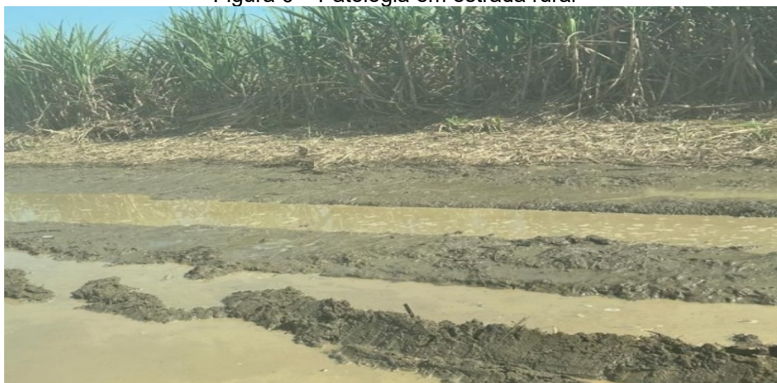
Figura 6 – Patologia em estrada rural
