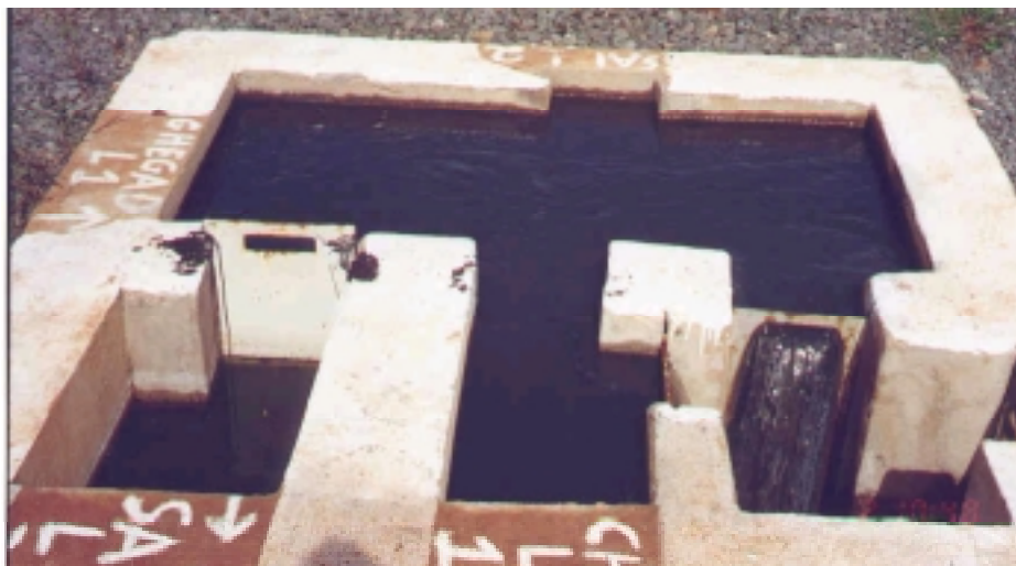
Figura 4.6 – Caixa de Distribuição múltipla (ponto 02)
