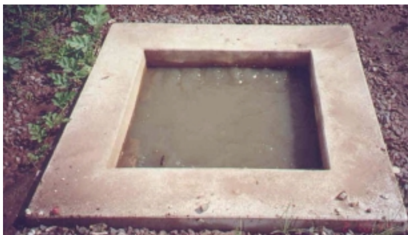
Figura 4.4 Caixa de distribuição e passagem da lagoa anaeróbia (ponto 01)
