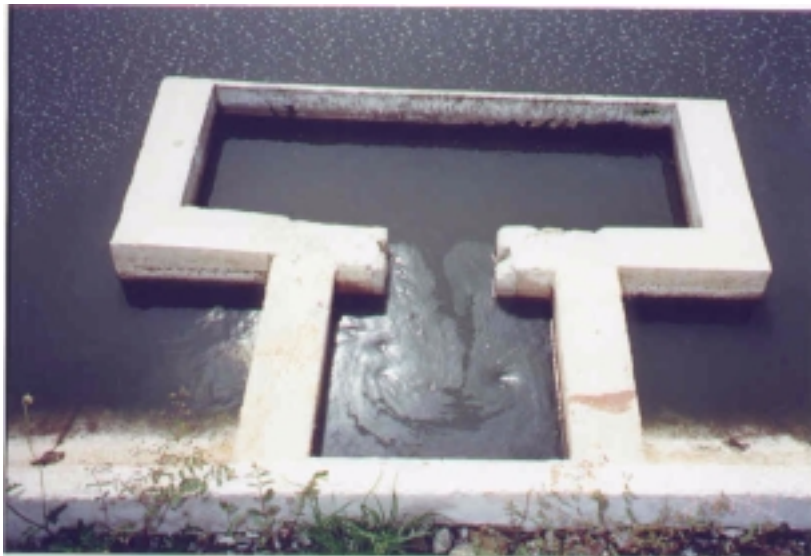
Figura 4.5 – Saída da lagoa anaeróbia
