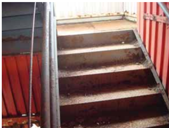
Figura 37 – Escada no interior do mirante, enferrujada e suja. Fonte: Foto tirada pela autora, 2011.
