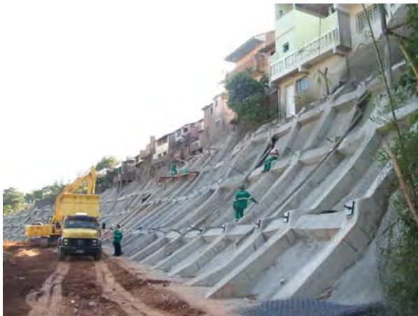
Figura 53: Cortina atirantada em São Luiz do Paraitinga. Fonte: Autor.
