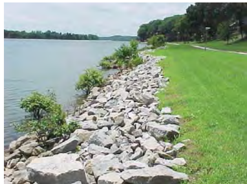
Figura 54: Exemplo de enrocamento. Fonte: http://www.orn.usace.army.mil/cof/Copy%20of%20Copy%20of%20MVC-021S.JPG
