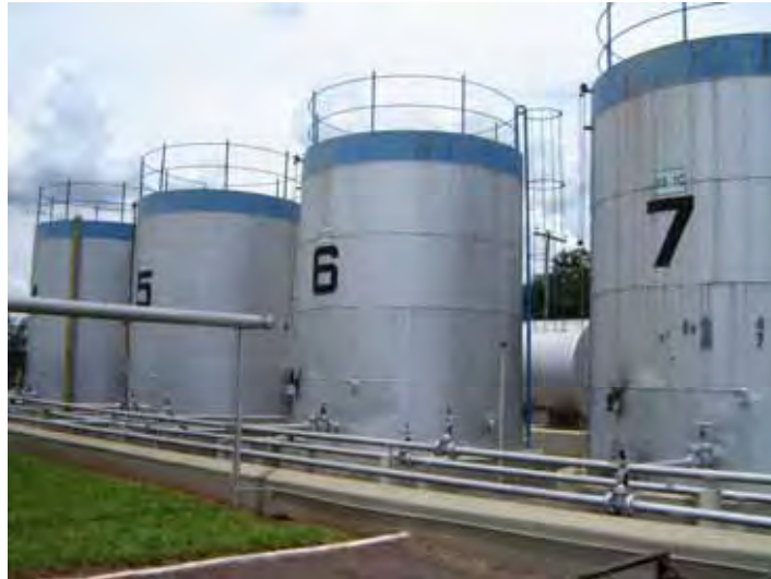
Figura 11 - Tanques de armazenamento.
