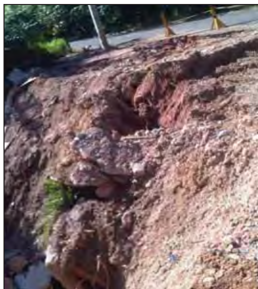
Foto 36 - deslizamento de encosta no bairro São Paulo em Pres. Prudente.
