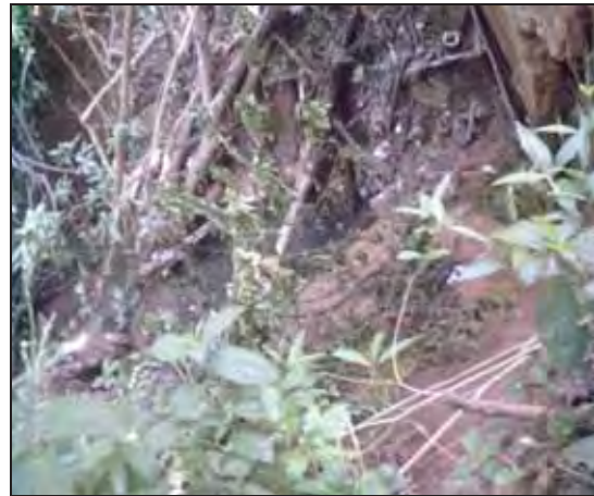
Foto 38 - assoreamento de nascente urbana em Álvares Machado.
