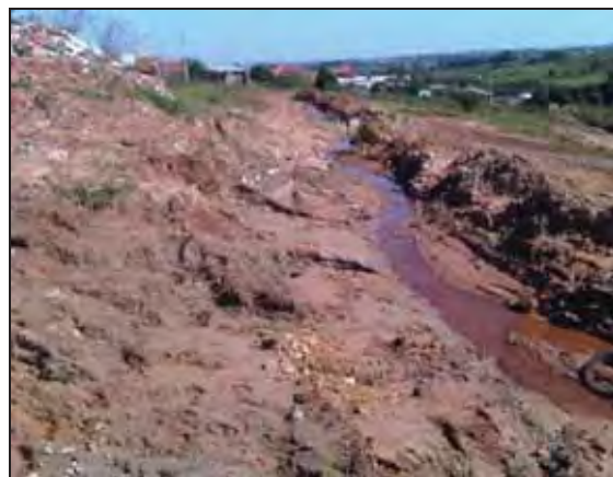
Foto 34 - obras de curvas de nível mal sucedidas, Cobral em Pres. Prudente.
