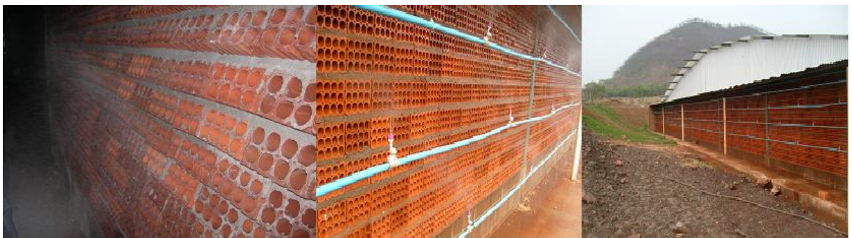
Figura 3. Vista parcial do pad cooling composto por blocos cerâmicos de 12 ou 8 furos e aspersão de água.
