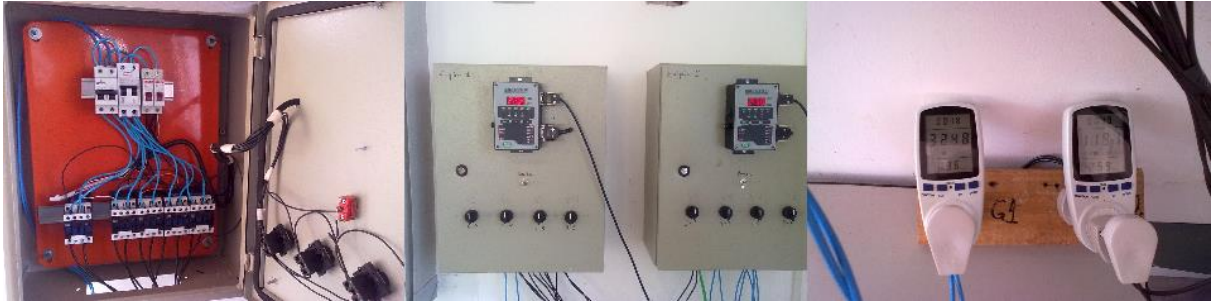
Figura 4 - Sistema automatizado de controle de climatização: caixas de comando, controlador digital de temperatura e umidade e medidores de consumo de energia elétrica.
