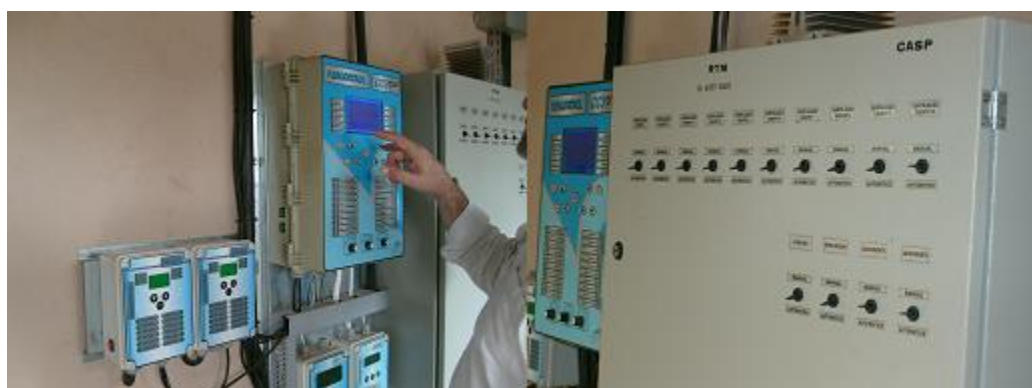
Figura 2. Sistema central automatizado de controle de climatização.
