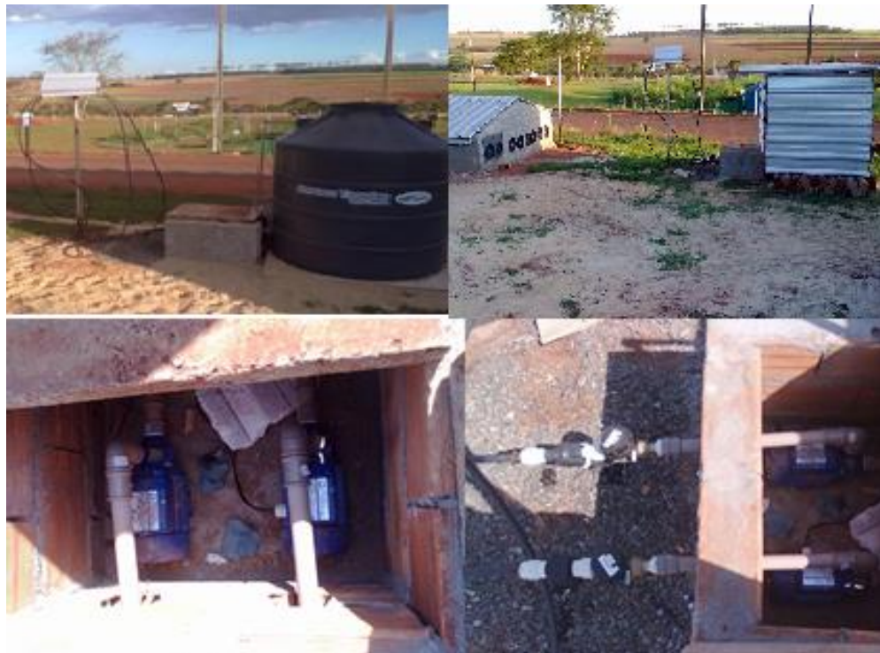
Figura 6 – Detalhe das bombas hidráulicas, hidrômetros e sistema hidráulico utilizado nos dois modelos.
