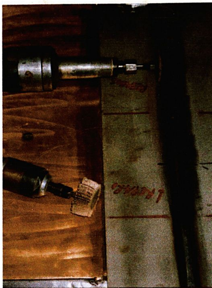
FIGURA 3.3 - Equipamento utilizado para a remoção do cordão de solda submetido à reparo(s).
