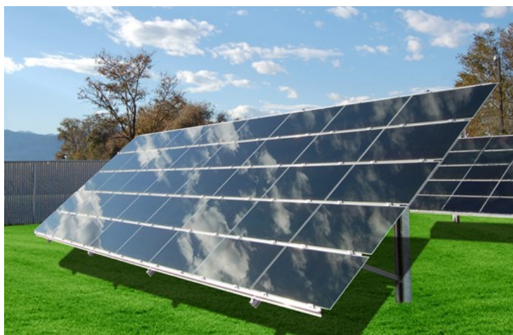
Figura 2 – Painel solar fotovoltaico
