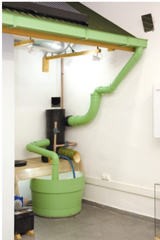
Figura 6 – Conjunto de calhas, condutores, filtros e cisterna de armazenamento de águas pluviais
