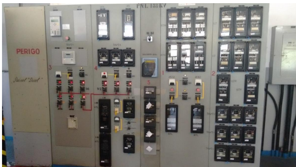
Figura 17 – Pannel de proteção e controle 138 kV com relés eletromecânicos
