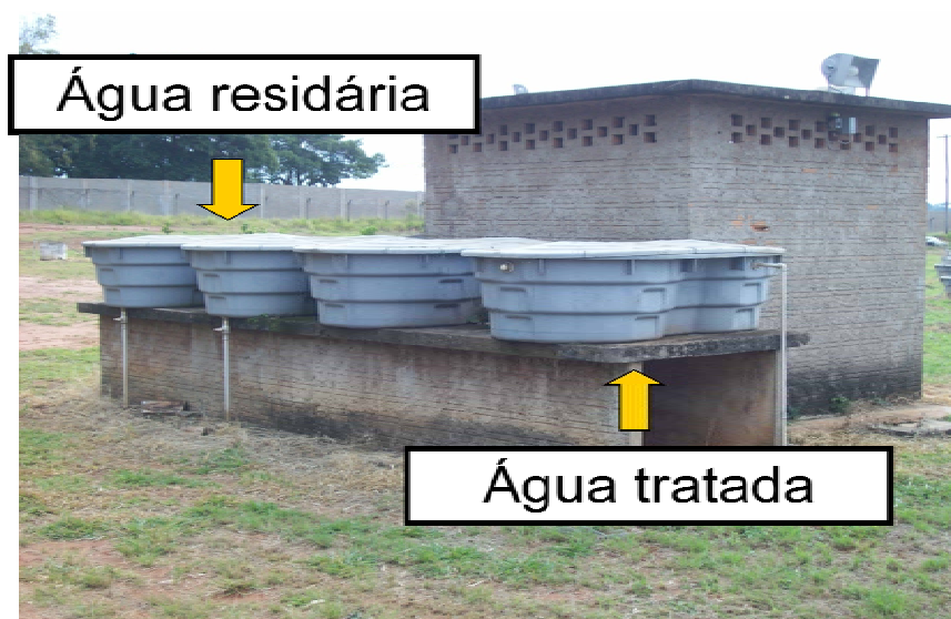
Figura 1 – Reservatórios utilizados para armazenamento da água utilizada. À esquerda, duas caixas d’água (1000 L cada) para armazenamento da água residuária e a direita, duas caixas d’água (1000 L cada) para armazenamento da água tratada.
