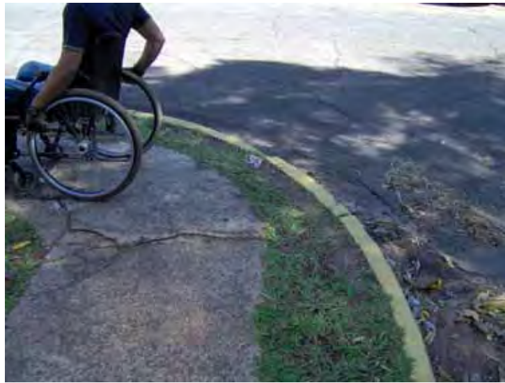
Figura 29 - Ausência de rebaixamento de calçada
