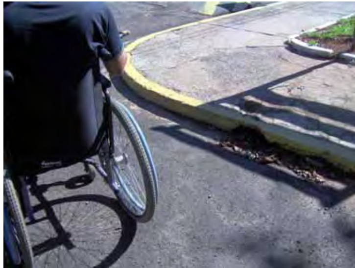
Figura 27 - Detalhe de ausência de rebaixamento de calçada
