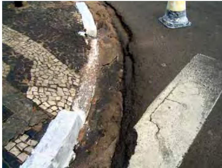
Figura 13 - Detalhe da depressão entre a rampa e a massa asfáltica
