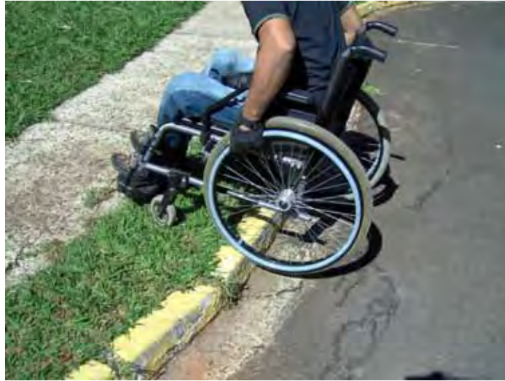
Figura 33 - Ausência de rebaixamento de calçada
