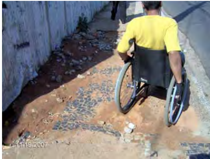
Figura 19 – Calçada danificada na Avenida Rodrigues Alves
