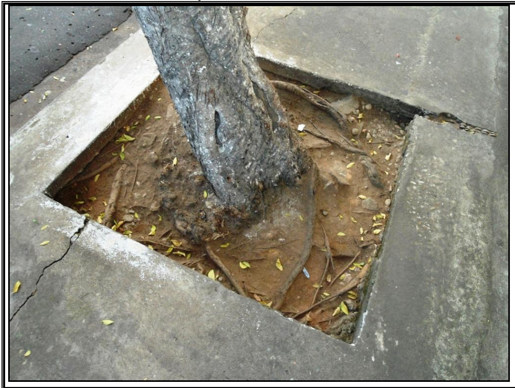
Figura 30 - Pithecellobium dulce com raiz visível sobre a superfície do solo causando rachaduras na calçada
