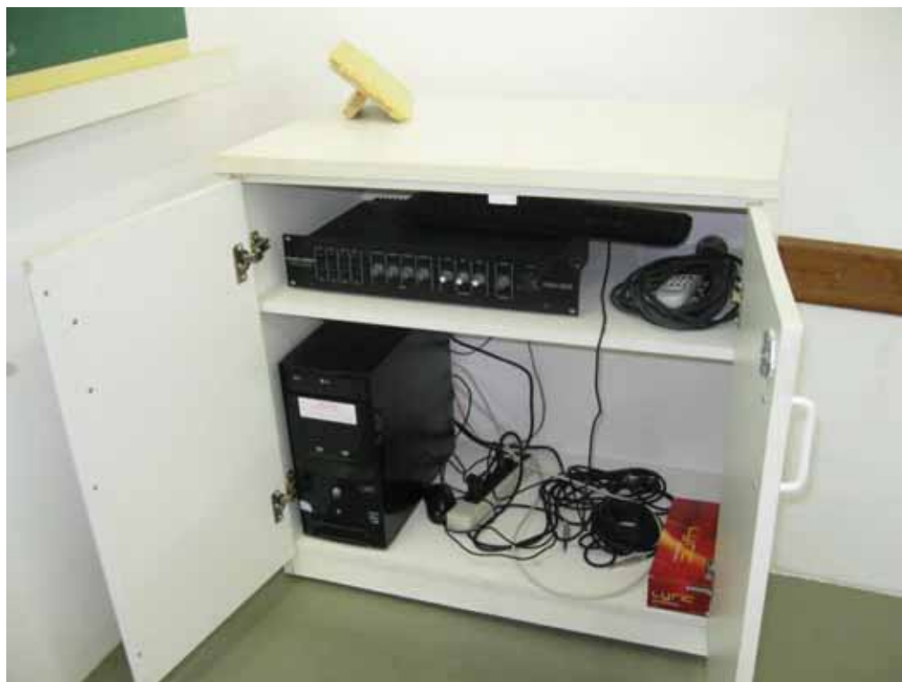
Figura 17 – Equipamento de som da Sala-Auditório
