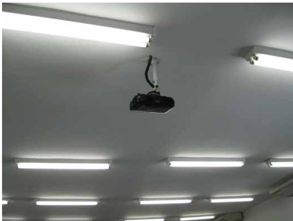
Figura 18 – Projetor multimídia instalado na Sala-Auditório
