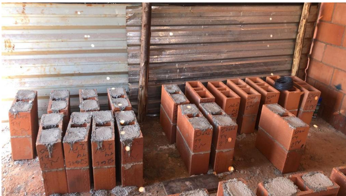
Figura 24 – Abrigo de prismas para controle tecnológico
