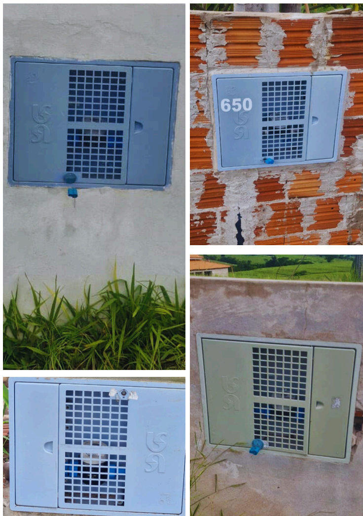
Figuras 75, 76, 77 e 78- Caixas padrão de ligação de água, instaladas no Chacreamento 01. Tiradas pelo autor, 2026.
