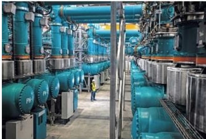
Figura 3: Subestação isolada a gás SF 6 (GIS)
