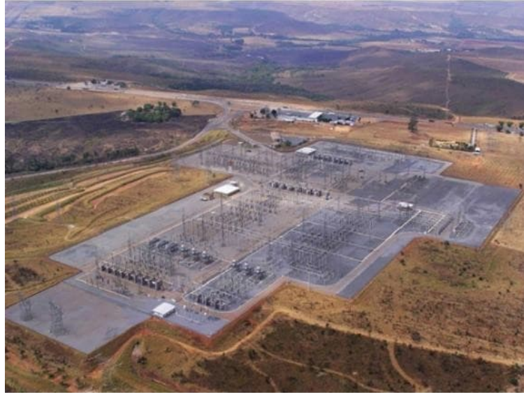
Figura 2: Subestação isolada a ar (AIS)
