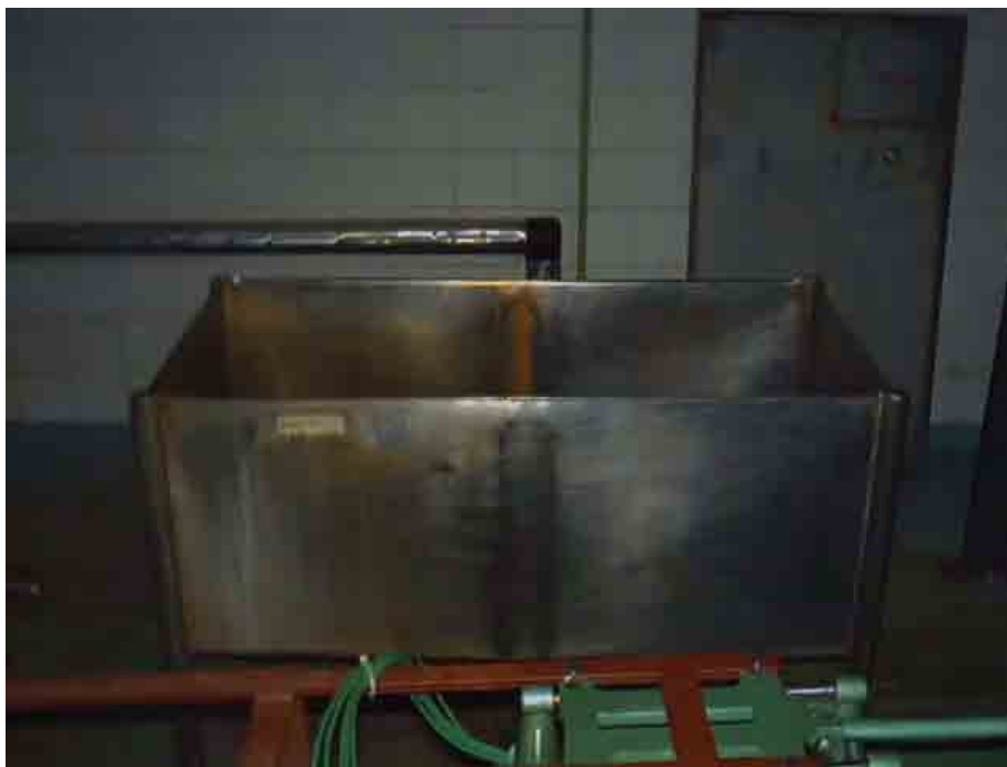
Figura 3. Tanque de pasteurização com aquecimento e resfriamento
