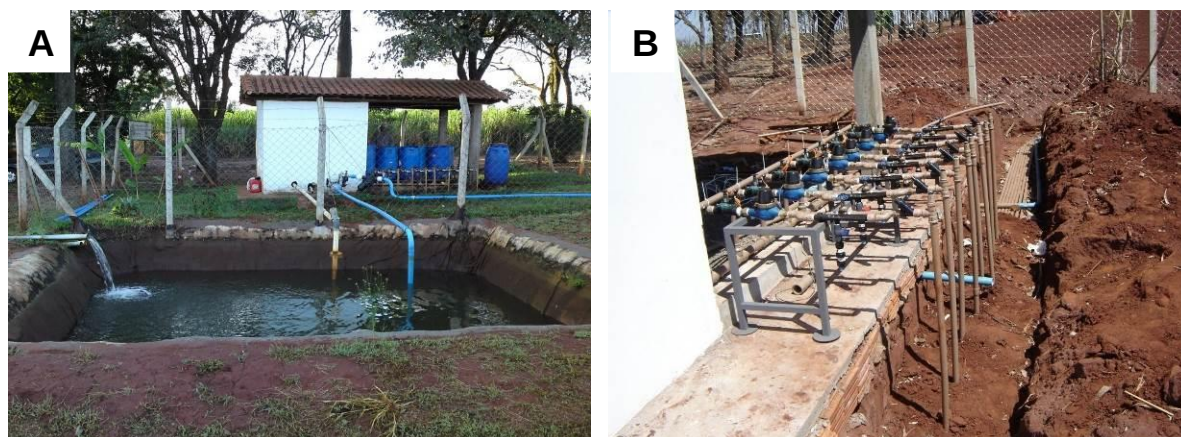
Figura 1. (A) Casa de abrigo do conjunto motobomba, registros e tanque de água, equipamentos já existentes no local. (B) Registros e injetores do tipo ‘venturi’ para controle e distribuição dos tratamentos fertirrigado.
