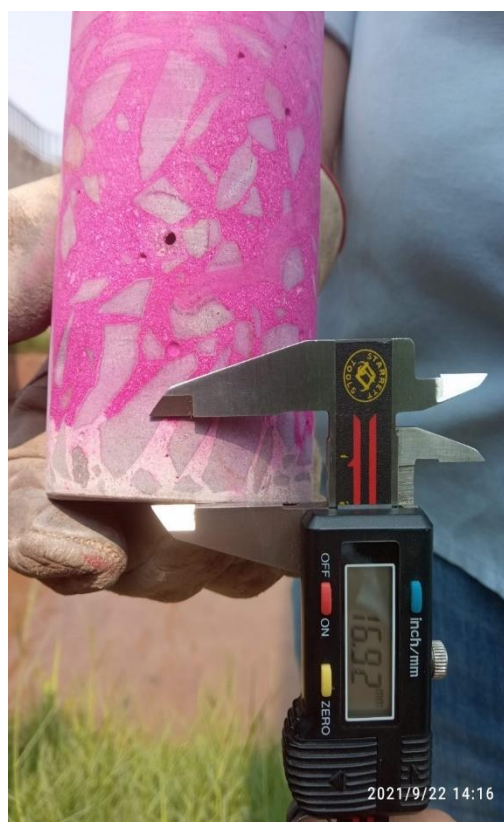
Figura 3.16: Aferição da profundidade de carbonatação em testemunho (SMO, 2022).
