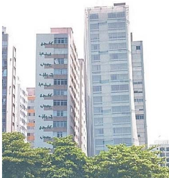
Figura 1.2 – Recalque diferencial em edifício em concreto armado na orla marítima de Santos-S.P. ( http://atribunadigital.globo.com )
