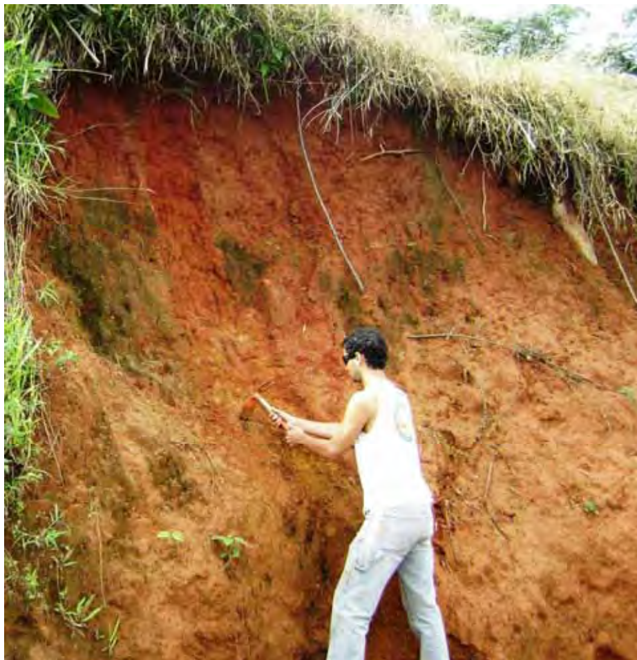
Foto 3 – Escorregamento verificado em vertente da Sub-Unidade II-B.
