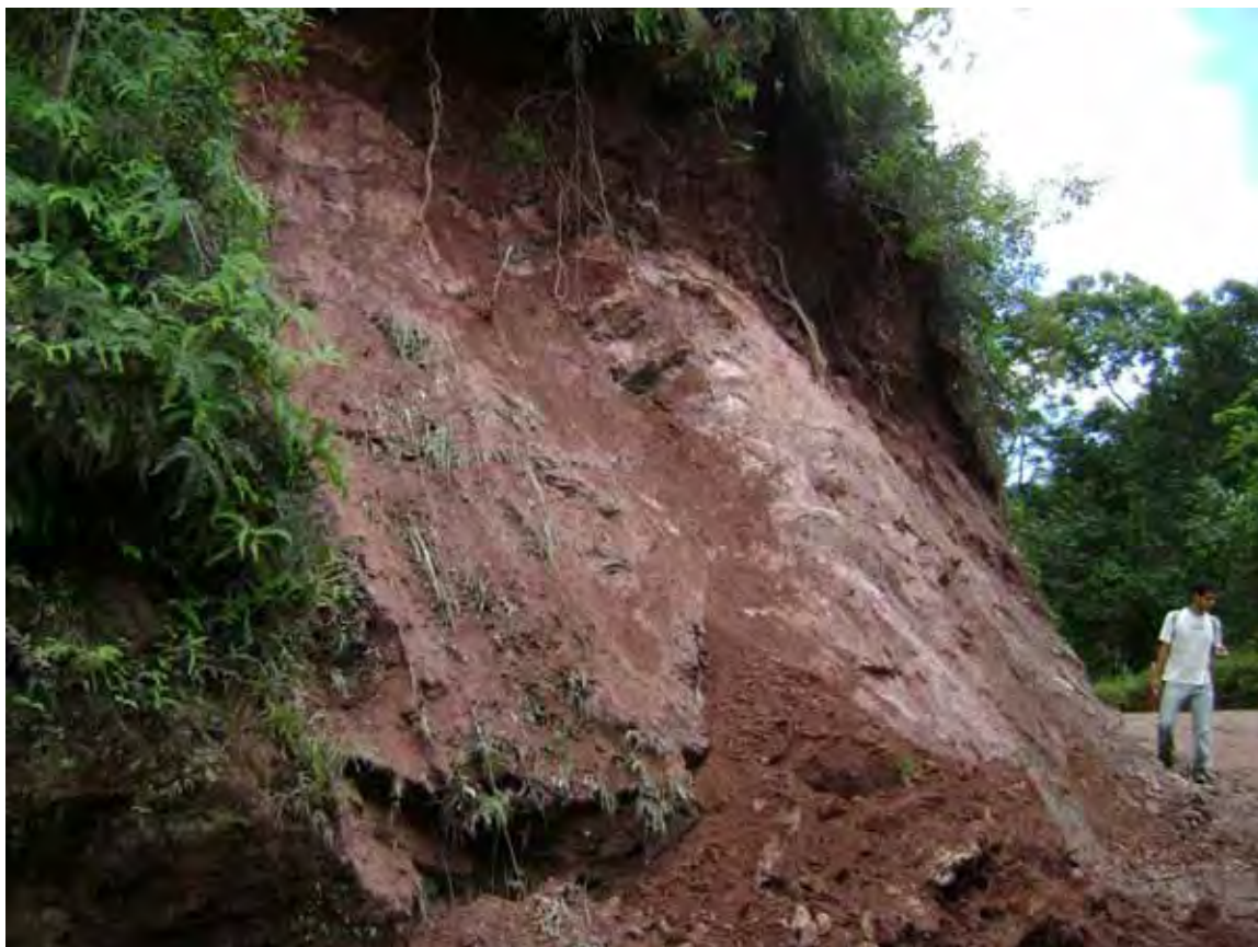
Foto 4 – Ponto de escorregamento em talude de corte de estrada
