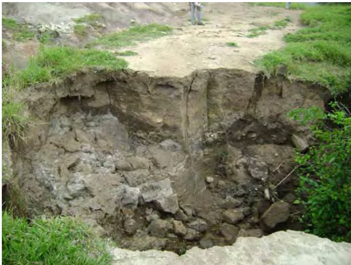
Foto 1 – Solapamento da margem fluvial do rio Atibainha.
