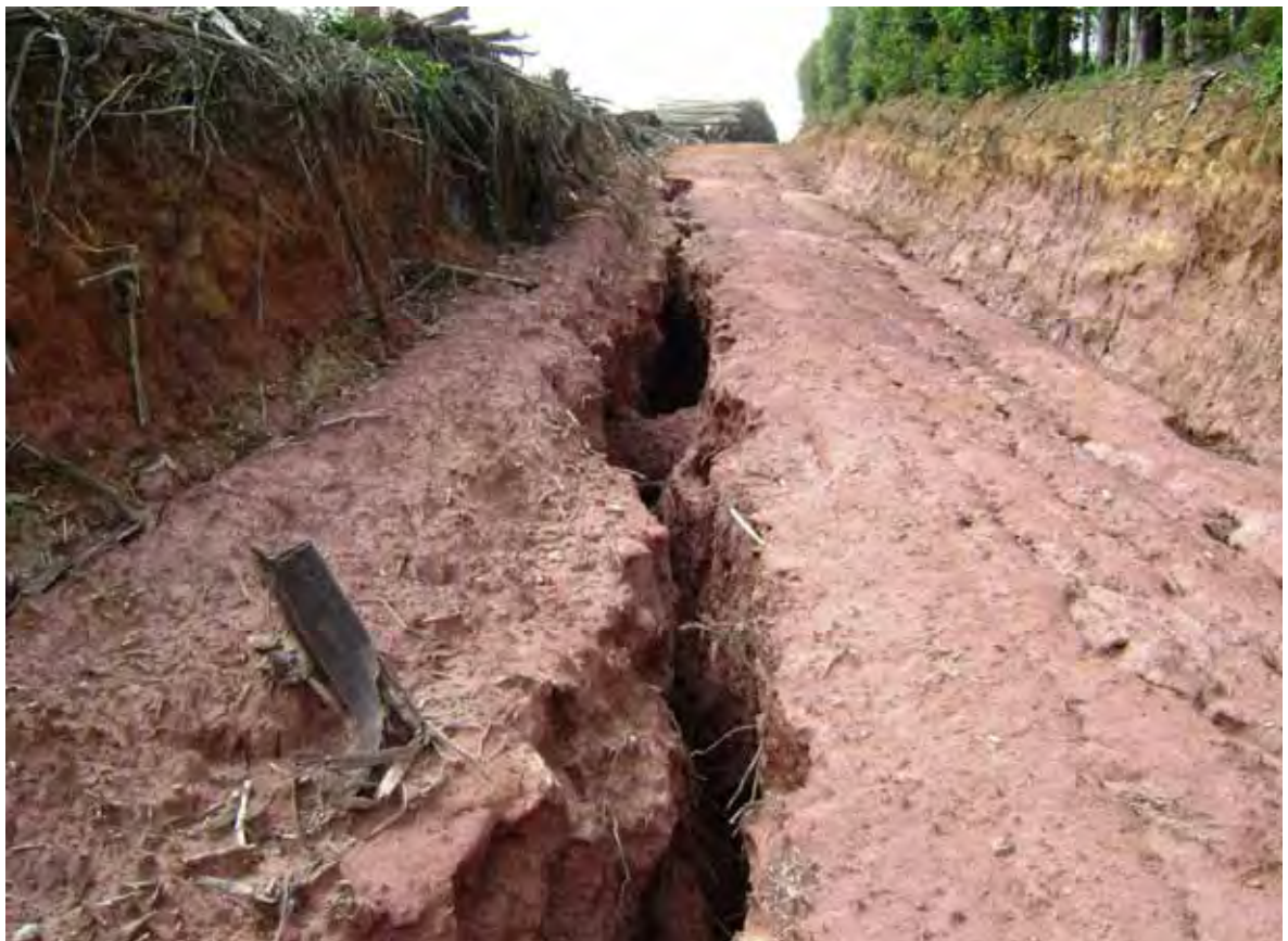
Foto 5 – Ravina profunda em terreno da Unidade IV desenvolvida no piso da estrada.
