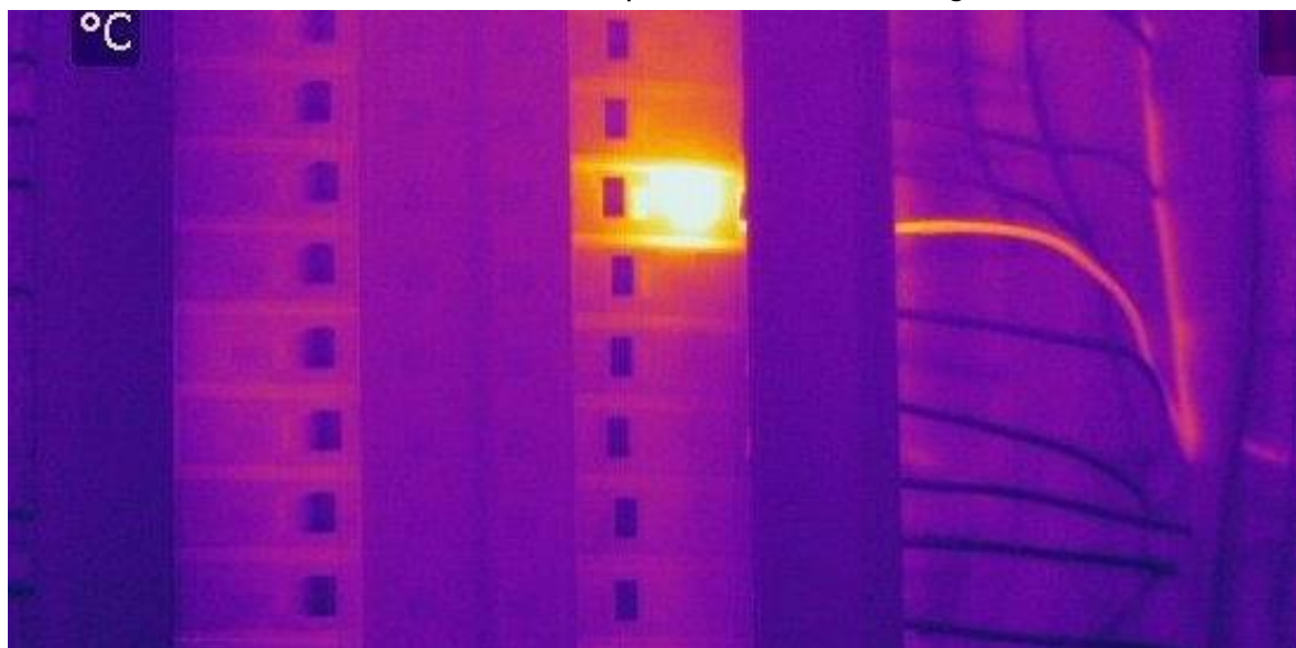
FIGURA 9 - Exemplo de Análise Termográfica
