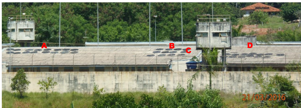
Figura 16. Sistema instalado no telhado da Unidade
