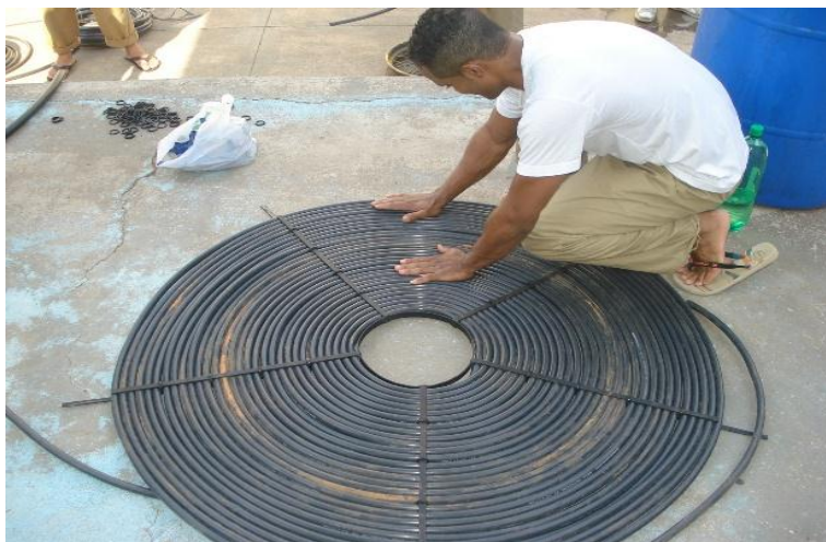
Figura 13. Coletor de tubo de polietileno disposto em forma de espiral
