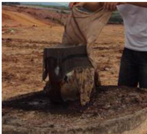
Figura 9: Procedimento para apagar as chamas dos drenos do aterro sanitário de Rio Claro (SP).
