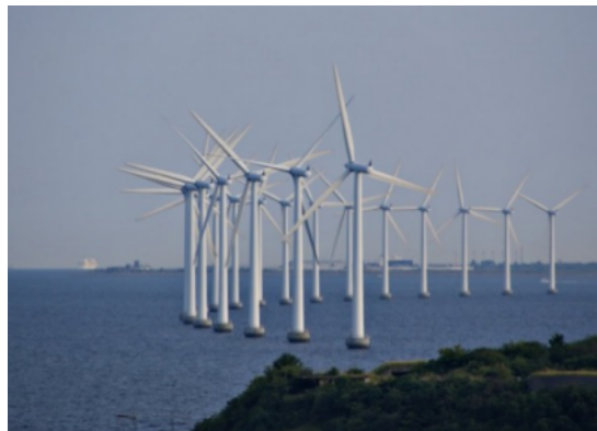
Figura 2.3: Parques eólicos instaladas offshore
