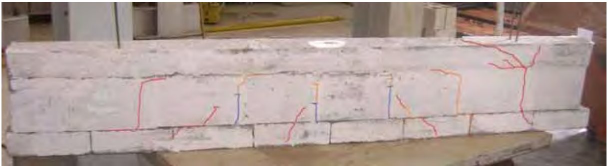
Figura 35 - Fissuras – Viga 1 – VI2b
