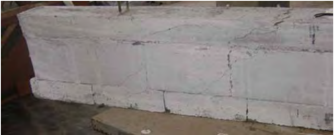
Figura 42 - Fissura típica de cortante no concreto da parte superior – Viga 2 – VI3
