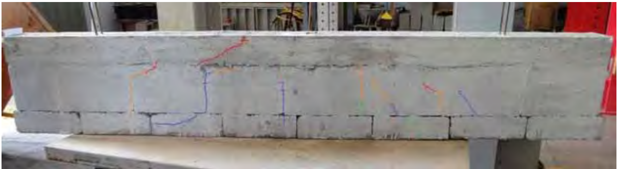
Figura 36 - Fissuras – Viga 2 – VI2b
