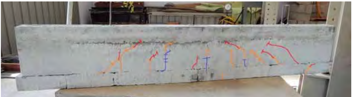
Figura 37 - Fissuras – Viga 1 – VI3
