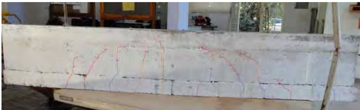
Figura 34 - Fissuras – Viga 2 – VI2a
