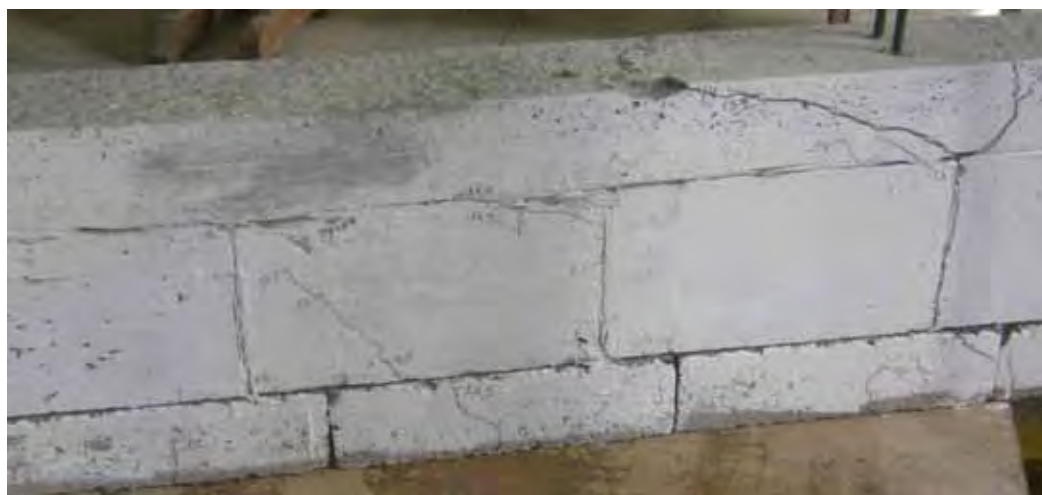
Figura 41 - Fissura típica de cortante no concreto da parte superior – Viga 1 – VI2b
