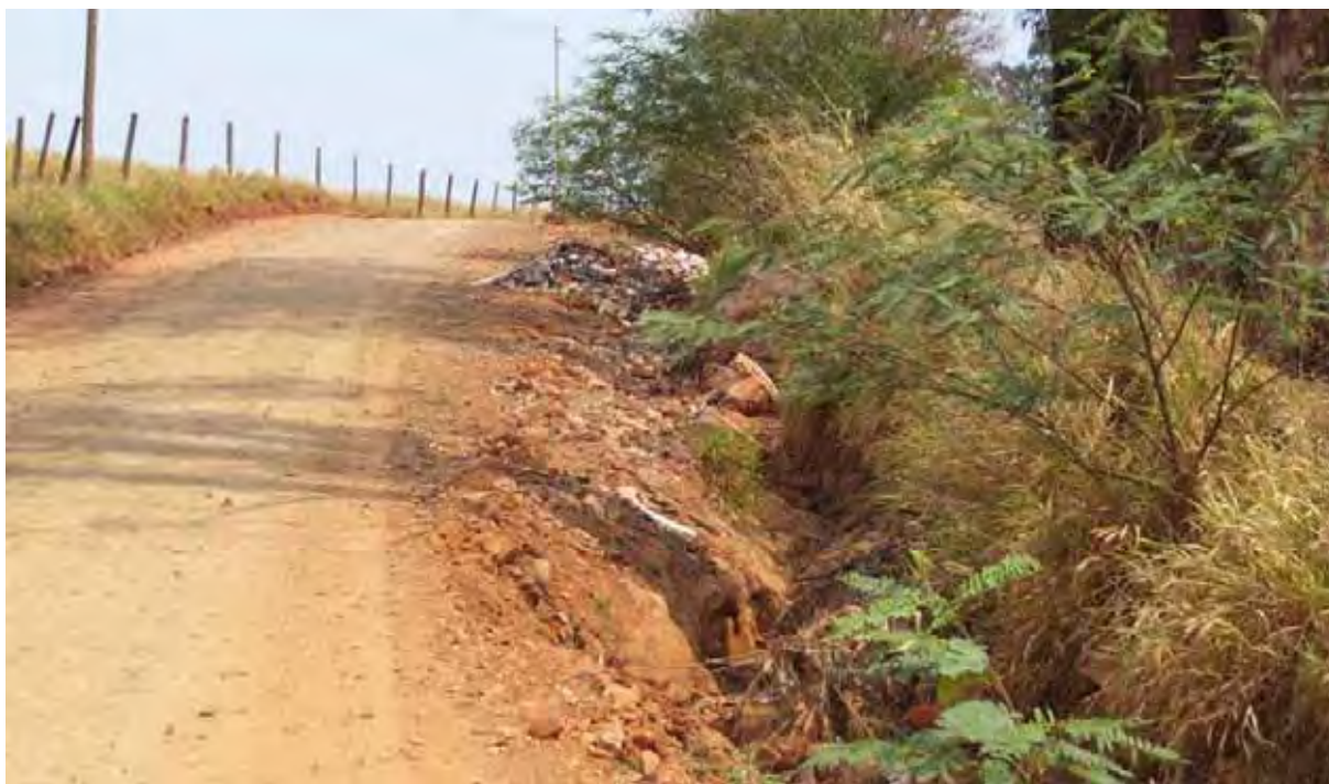
Foto 4: Estrada rural em condições precárias localizada na microbacia da água do Pavão/Matão.
