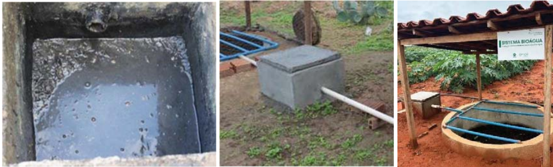
Figura 2 – Águas cinzas na caixa de gordura sendo conduzidas ao SBF.
