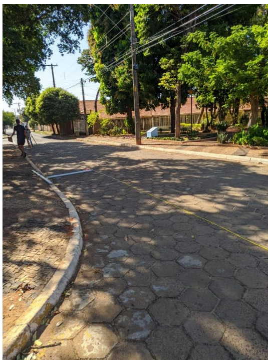
Figura 17 – Pavimento não homogêneo presente no trecho 2
