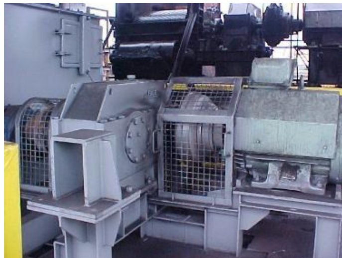
Figura 14 – Conjunto de acionamento
