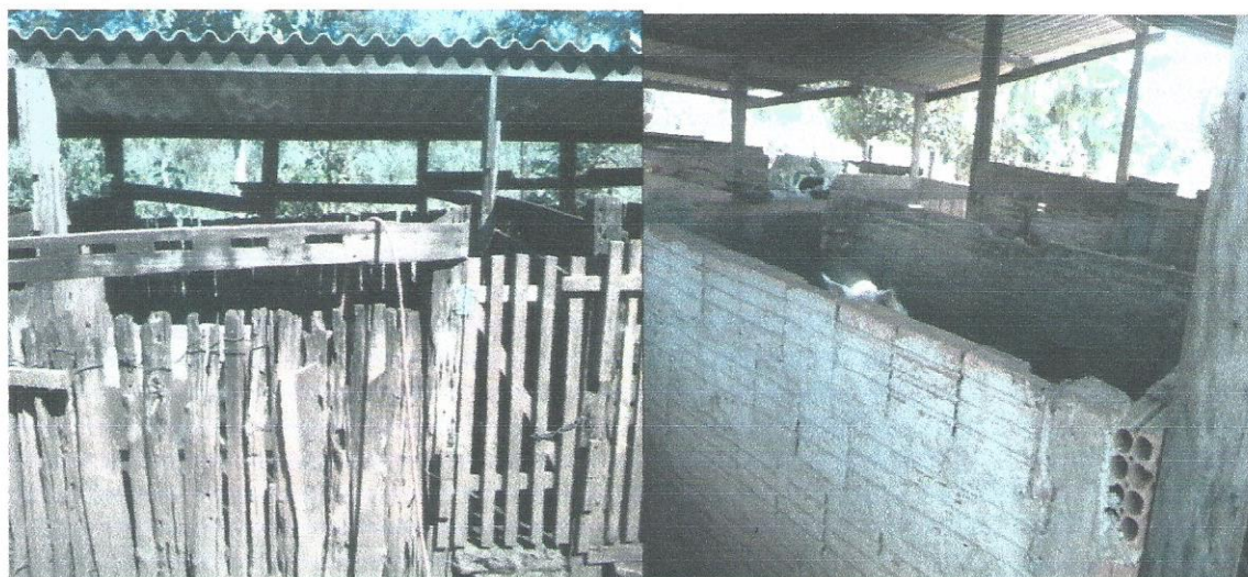
Figura 3: Cercado de madeira em condições ruins (esquerda) e parede de alvenaria somente com o chapisco sem acabamento (direita).
