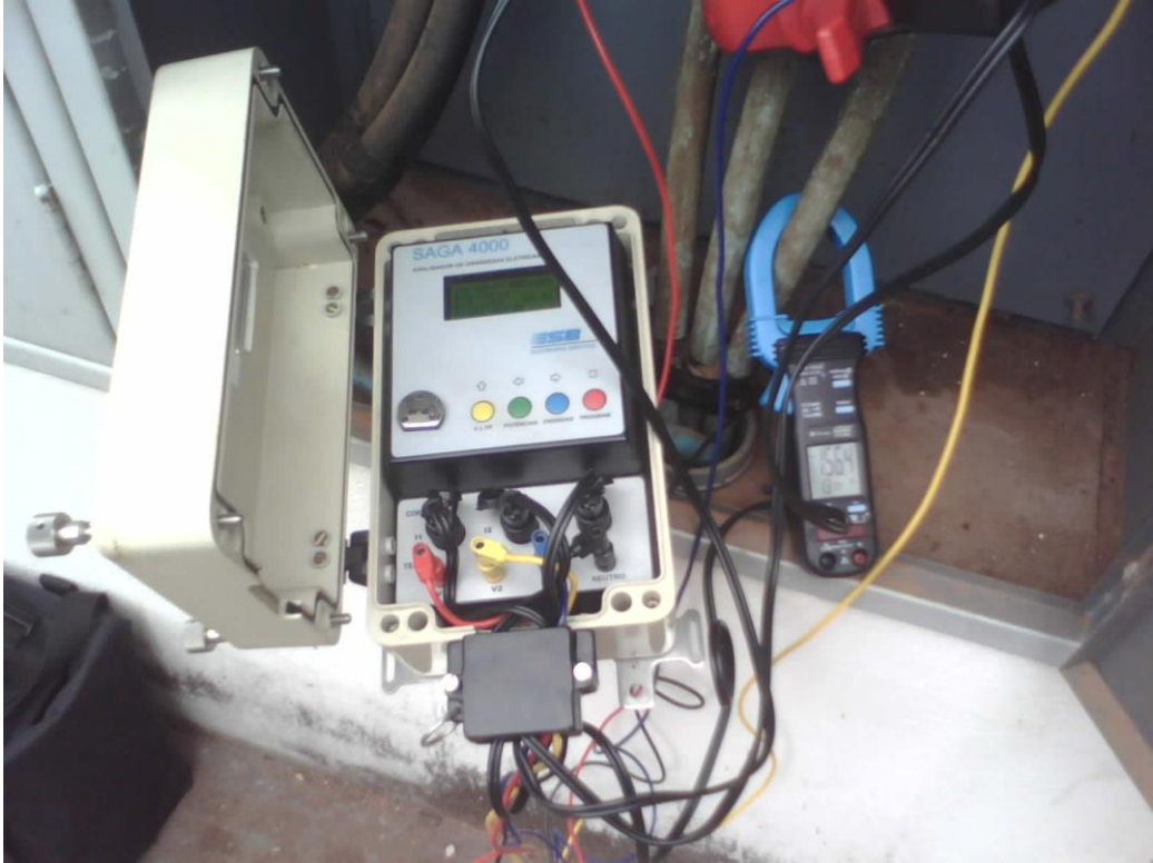
Figura 15. Detalhe do analisador de grandezas no quadro geral de entrada de energia.
