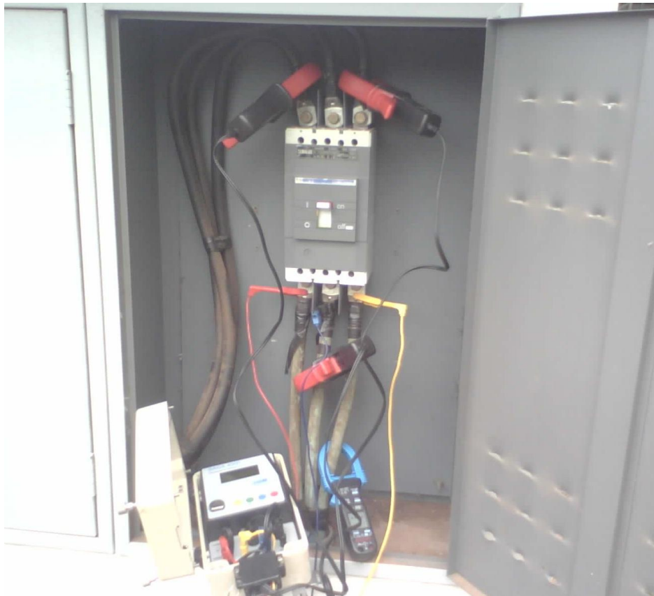
Figura 16. Analisador de grandezas instalado no quadro geral de entrada de energia.
