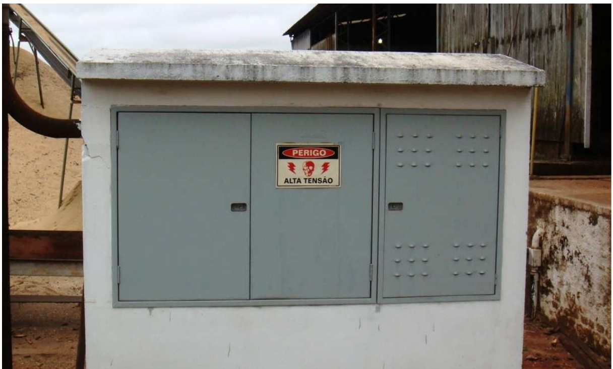
Figura 14. Vista externa do quadro geral de entrada de energia.
