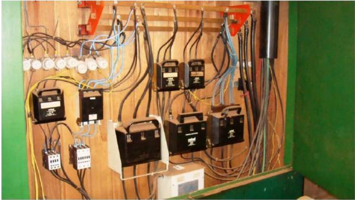
Figura 17. Vista interna do quadro de distribuição de energia da serra de fita vertical.
